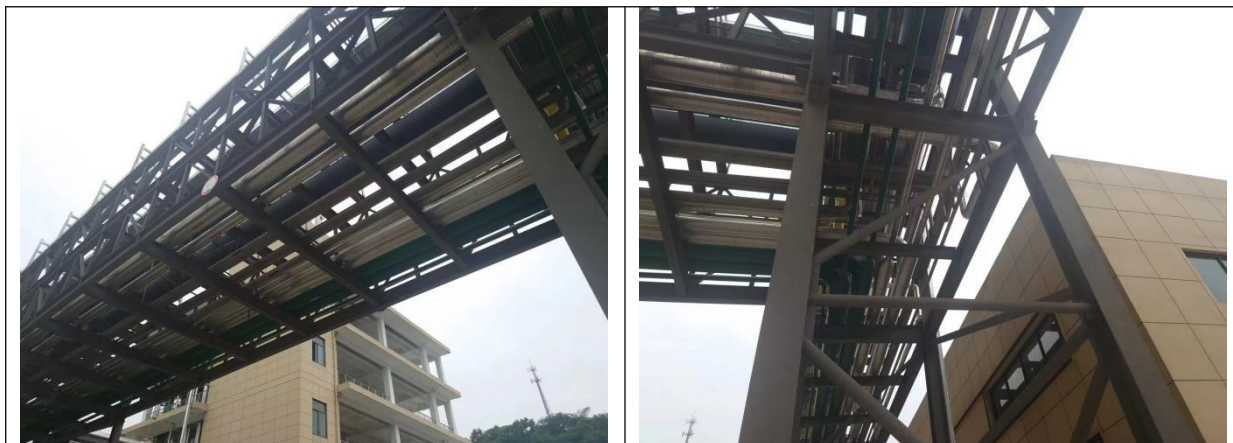
厂区架空管道
