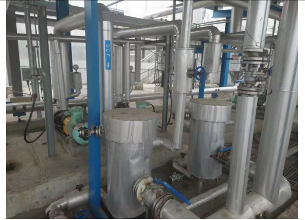
罐区管道传输泵
