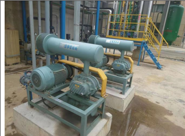
污水站传输泵
