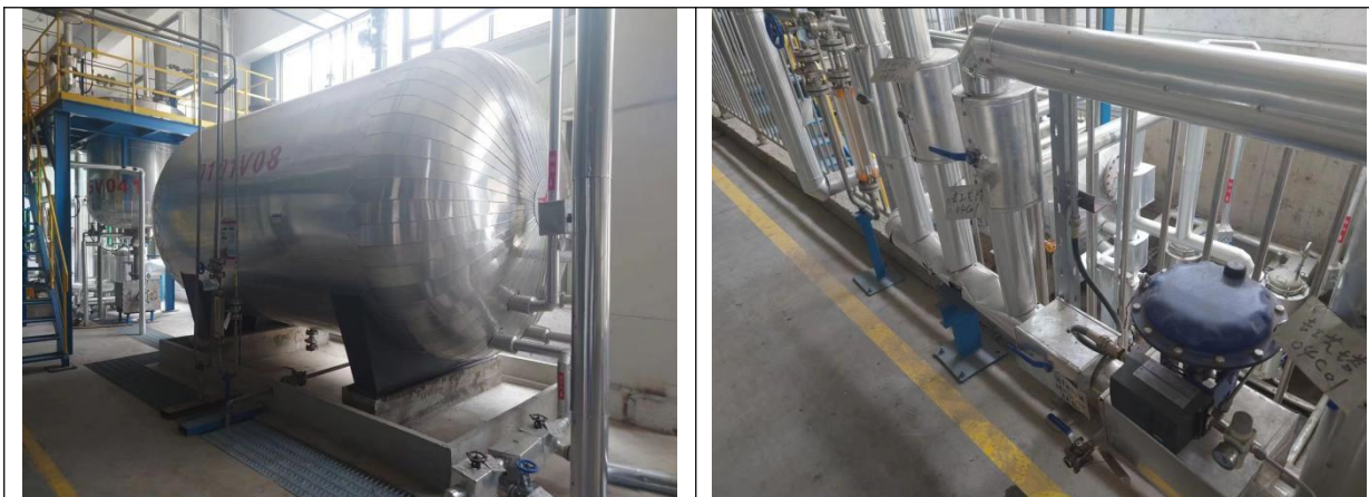
酯化车间储罐
