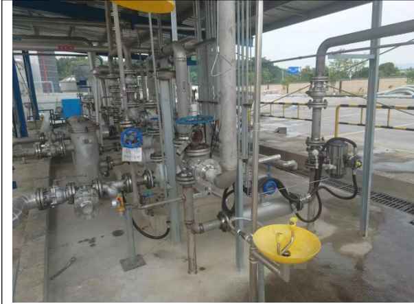
罐区管道传输泵
