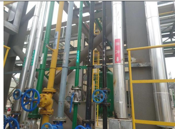
污水站管道阀门
