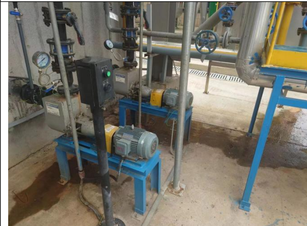
污水站传输泵
