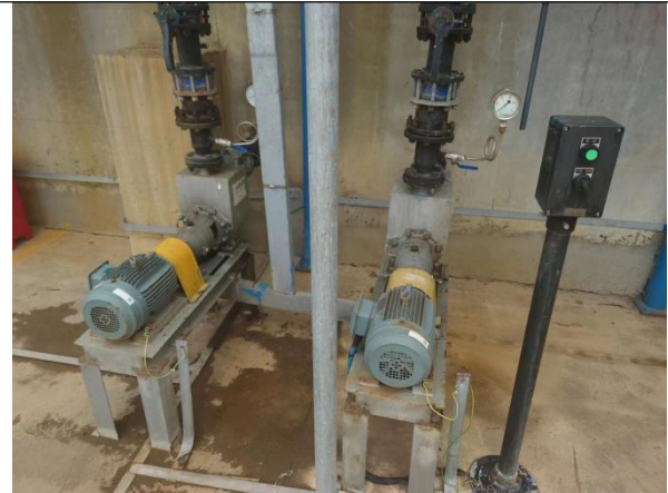
污水站传输泵
