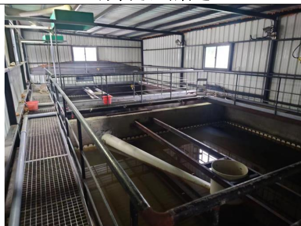
污水处理站污水池
