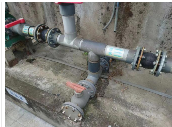
污水处理站管道
