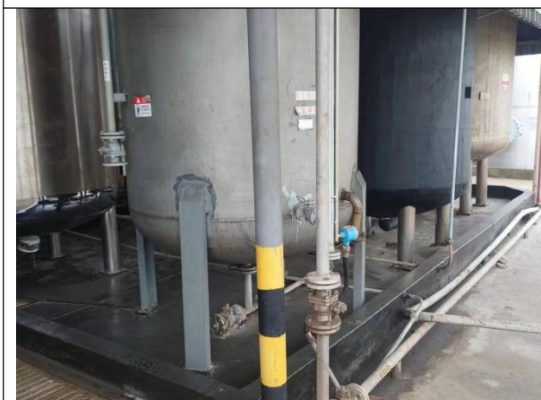
合成车间二离地储罐
