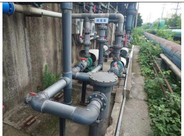
污水处理站管道
