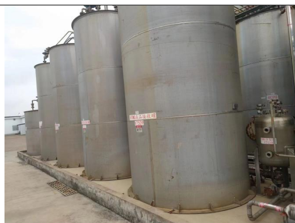
溶剂回收车间接地储罐
