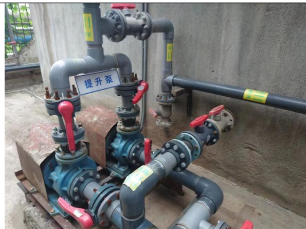
污水处理站提升泵
