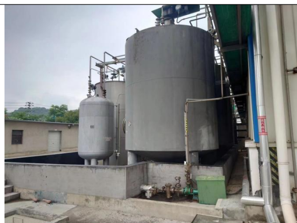
溶剂回收车间离地储罐
