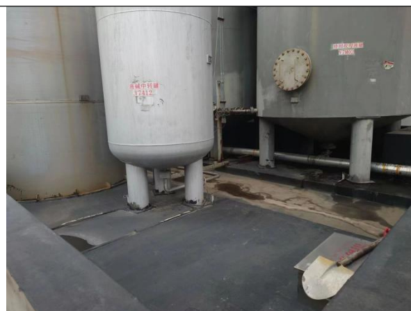
溶剂回收车间接地储罐
