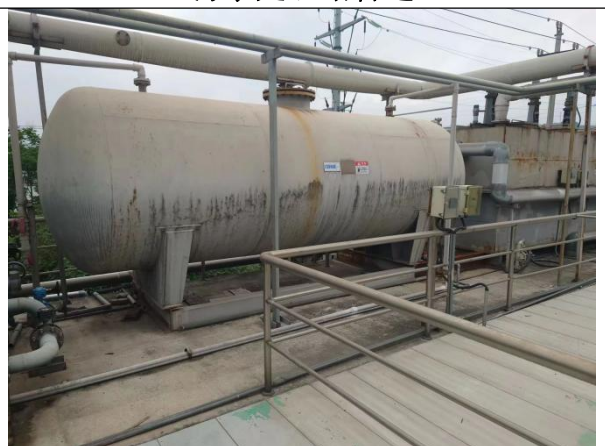
污水处理站离地储罐
