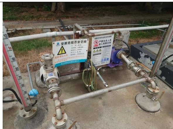
合成车间二污水池传输泵
