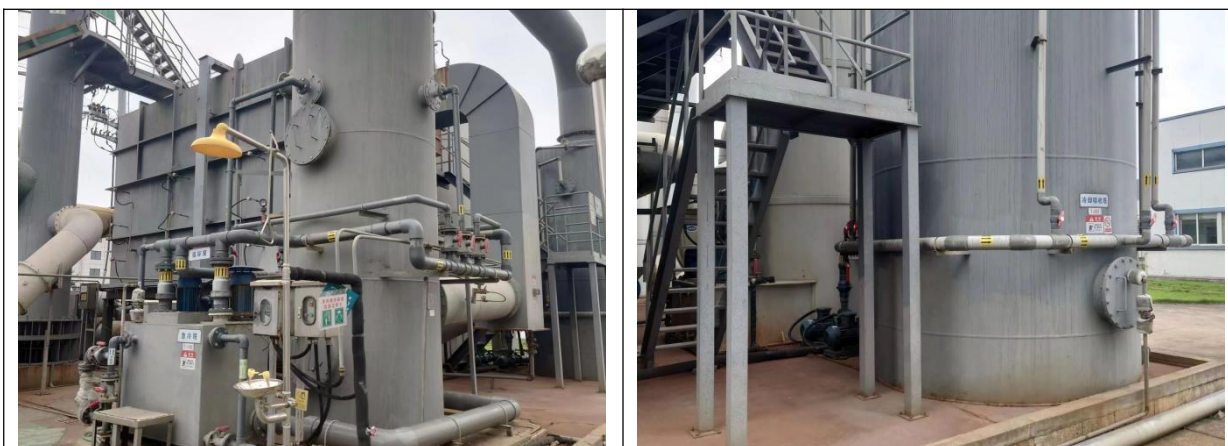
RTO废气处理设施
