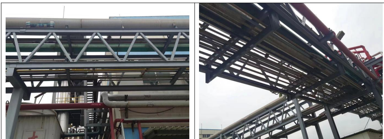
厂区架空管道
