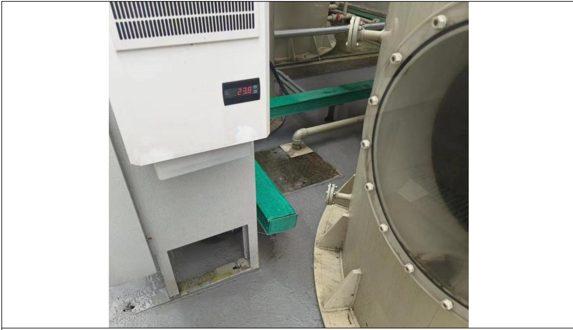
围堰完好，无开裂、渗漏，降雨可通过管道接至厂区废水处理区
