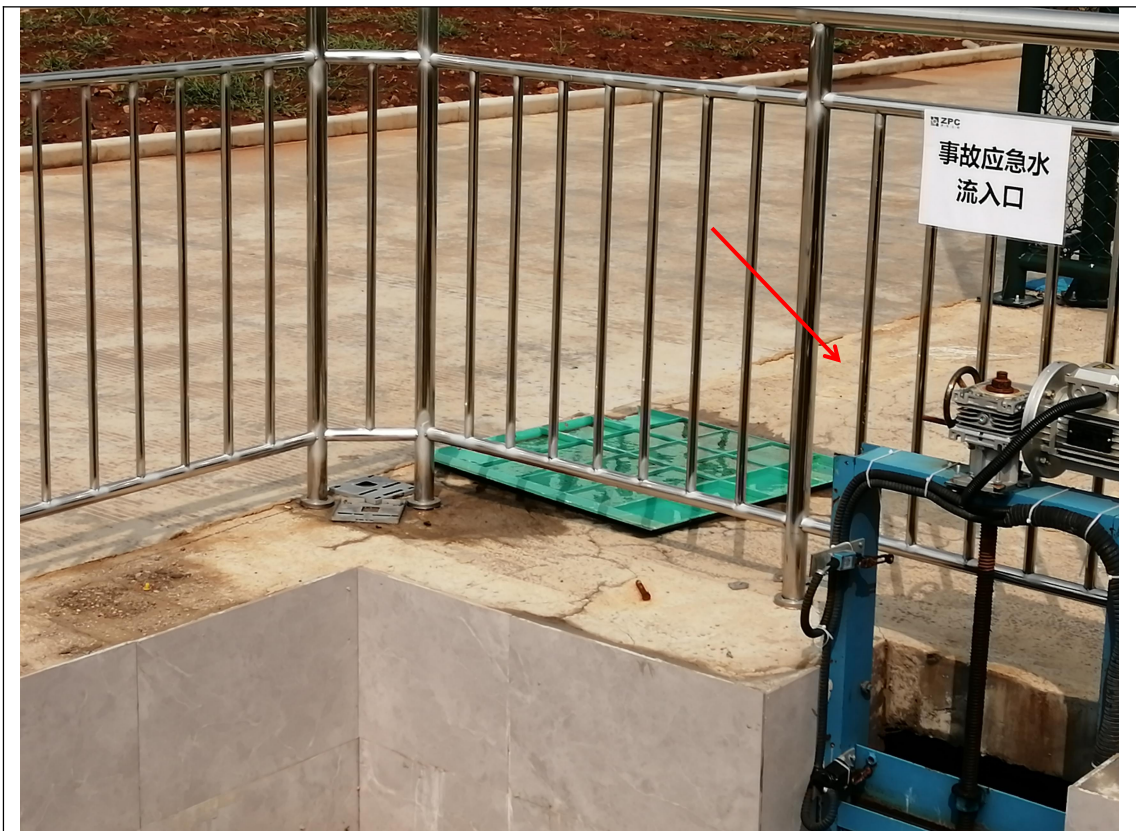
事故应急池整体情况
