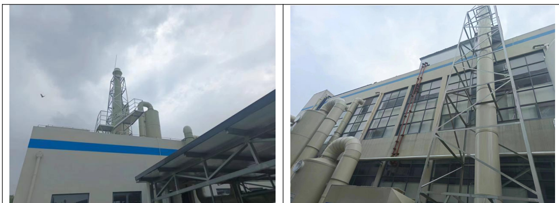
废气处理设施
