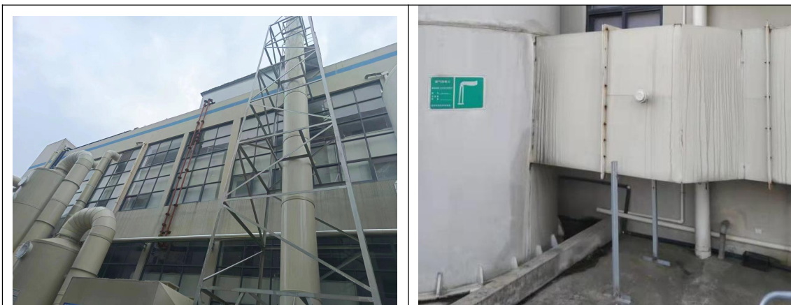
废气处理设施整体情况
